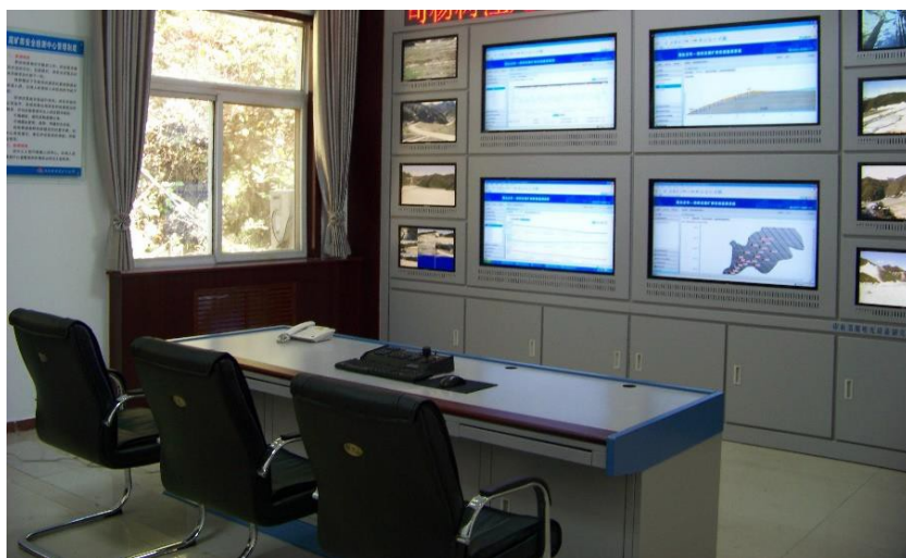
某工程监控中心实景图
