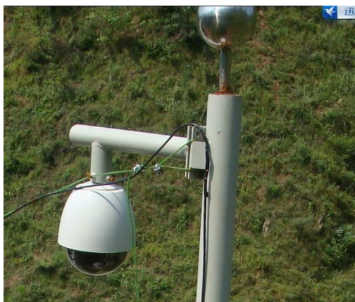
球机安装实景图
